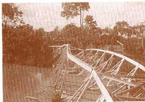
La Caída del puente La Balsa el 20 de julio de 1984, causada por un accidente automovilístico, interrumpió el paso por el puente durante varios meses y obstaculizó la vía a Villavicencio.
